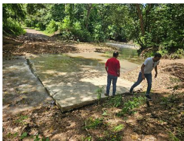
Figura N° 20. Inspección de caminos afectados por aguaceros
